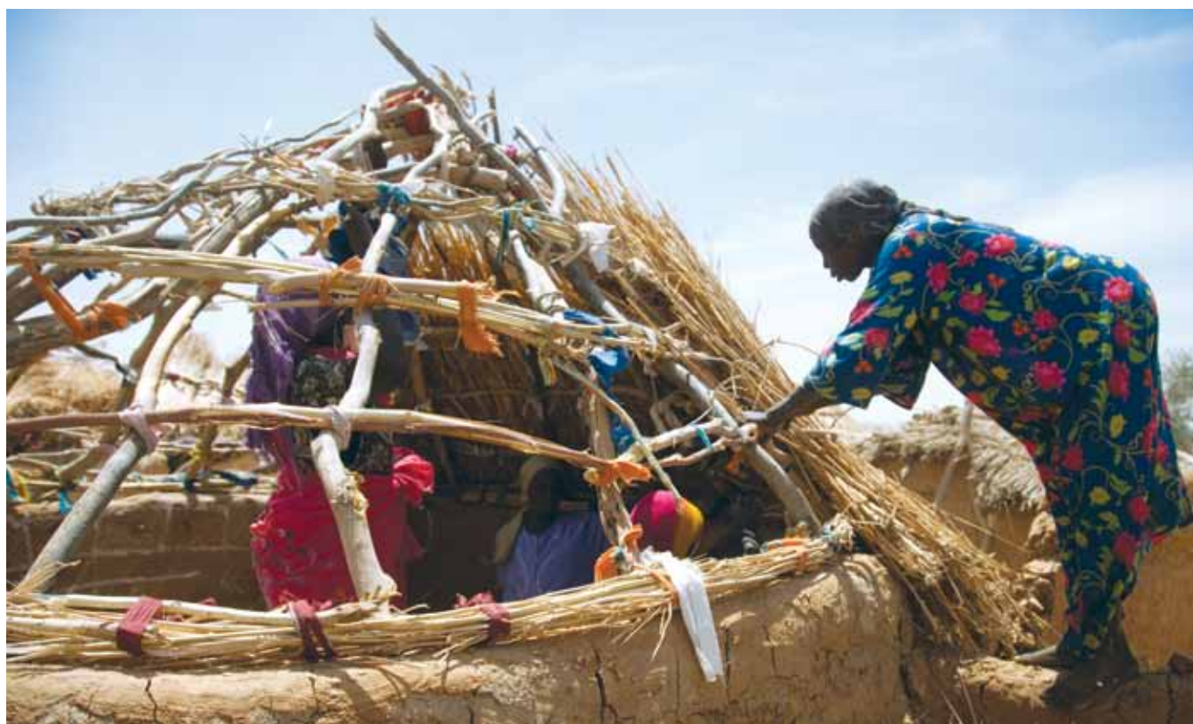
Tchad : construction du toit d'une salle dans le camp de réfugiés de Kounougou. (Don Doll SJ/JRS)
