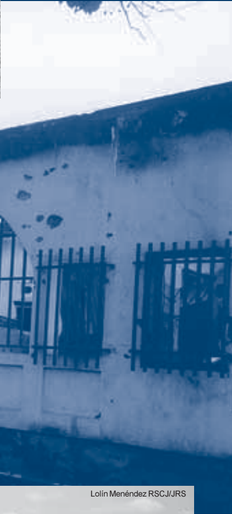
Construction détruite en Guinée
